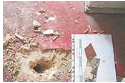
asbesthaltige zweischichtige PVC-Rollenware
